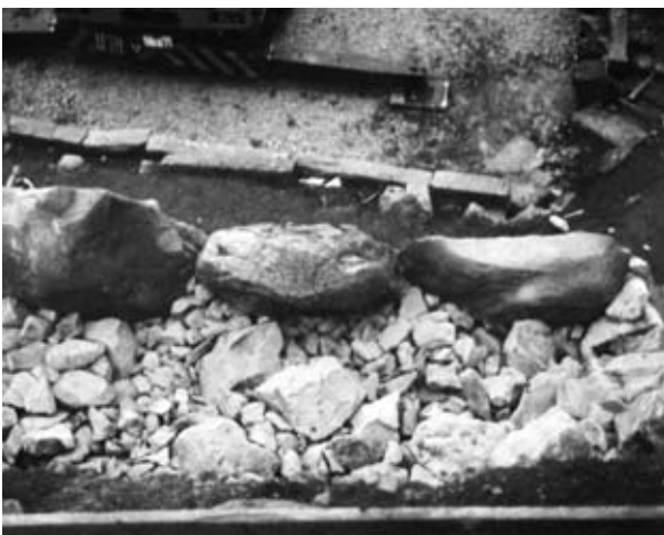
7 石積み工 (石垣①) 控えが薄い
