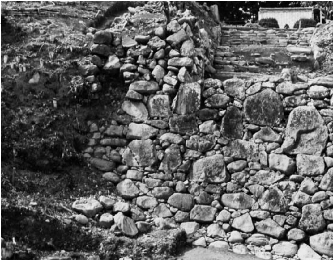
2 山里口石垣① 石垣欠落状況（南東から）
